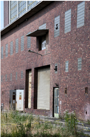
Kraftwerk Frimmersdorf II: Schaltanlagenvorbau Block B, Ansicht von Nordosten; Foto: 23.06.2023 Fotograf/Urheber: Dr. Norbert Gilson
