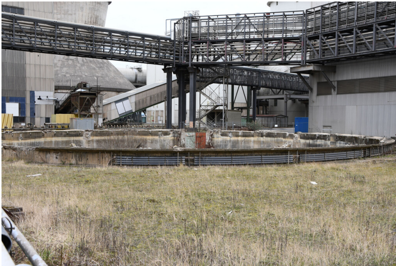
Kraftwerk Frimmersdorf II: Ventilator-Kühlturmtasse 31, Ansicht von Südwesten; Foto: 22.03.2023 Fotograf/Urheber: Dr. Norbert Gilson
