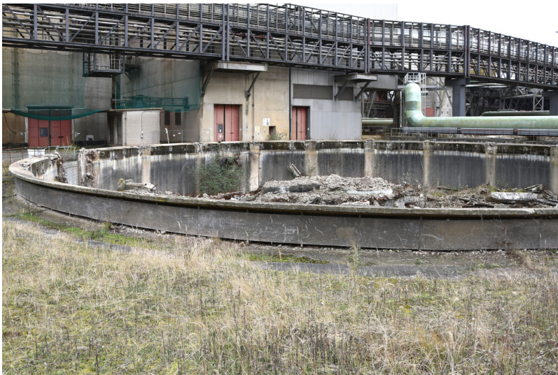
Kraftwerk Frimmersdorf II: Ventilator-Kühlturmtasse 29, Ansicht von Westen; Foto: 22.03.2023 Fotograf/Urheber: Dr. Norbert Gilson
