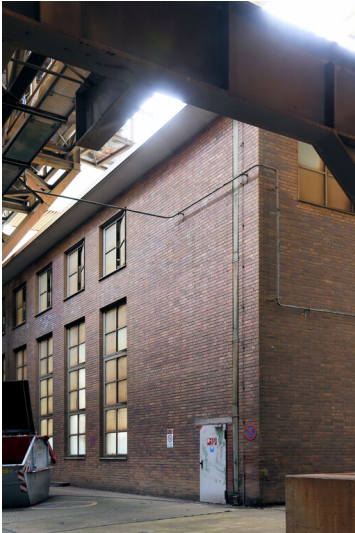
Kraftwerk Frimmersdorf II: Kühlwasser-Pumpenhaus 3, Ansicht von Nordosten; Foto: 21.03.2023 Fotograf/Urheber: Dr. Norbert Gilson
