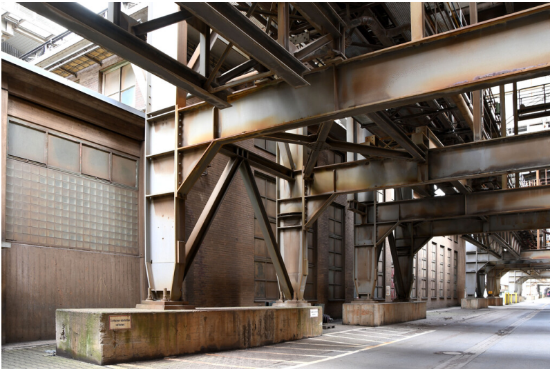
Kraftwerk Frimmersdorf II: Kühlwasser-Pumpenhaus 2, Ansicht von Süden; Foto: 21.03.2023 Fotograf/Urheber: Dr. Norbert Gilson
