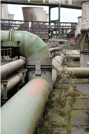
Kraftwerk Frimmersdorf II: Kühlwasserleitungen östlich von Kühlturm 26, Zuführungen in die Kühltürme, Ansicht von Norden; Foto: 22.03.2023 Fotograf/Urheber: Dr. Norbert Gilson
