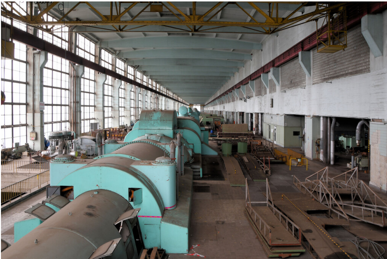
Kraftwerk Frimmersdorf II: Maschinenhaus, Innenansicht von Norden in Richtung Blöcke K/L/M; Foto: 21.03.2023 Fotograf/Urheber: Dr. Norbert Gilson
