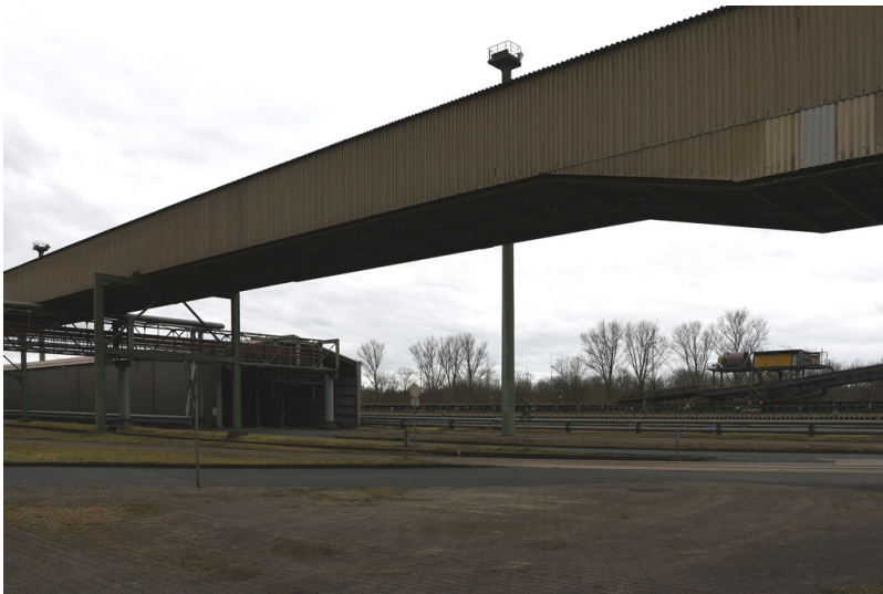
Kraftwerk Frimmersdorf II: Entschung Blöcke P/Q, Aschebandbrücke zur Asche-Waggonverladung, Ansicht von Nordosten; Foto: 22.03.2023 Fotograf/Urheber: Dr. Norbert Gilson
