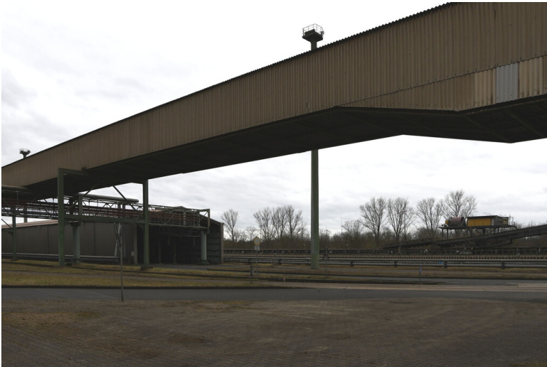
Kraftwerk Frimmersdorf II: Entschung Blöcke P/Q, Aschebandbrücke zur Asche-Waggonverladung, Ansicht von Nordosten; Foto: 22.03.2023 Fotograf/Urheber: Dr. Norbert Gilson
