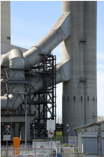
Kraftwerk Frimmersdorf II: Rauchgasreinigung, Reingas- und Bypasseinleitung von den Blöcken P und Q in REA-Kamin 4, Ansicht von Nordosten; Foto: 04.05.2023 Fotograf/Urheber: Dr. Norbert Gilson
