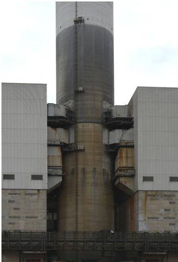
Kraftwerk Frimmersdorf II: Reingaseinleitungen in REA-Kamin 2, Ansicht von Westen; Foto: 22.03.2023 Fotograf/Urheber: Dr. Norbert Gilson
