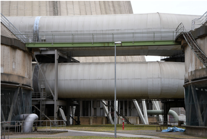
Kraftwerk Frimmersdorf II: Rauchgasreinigung, Rohgasrohre Blöcke P und Q, Ansicht von Süden; Foto: 22.03.2023 Fotograf/Urheber: Dr. Norbert Gilson
