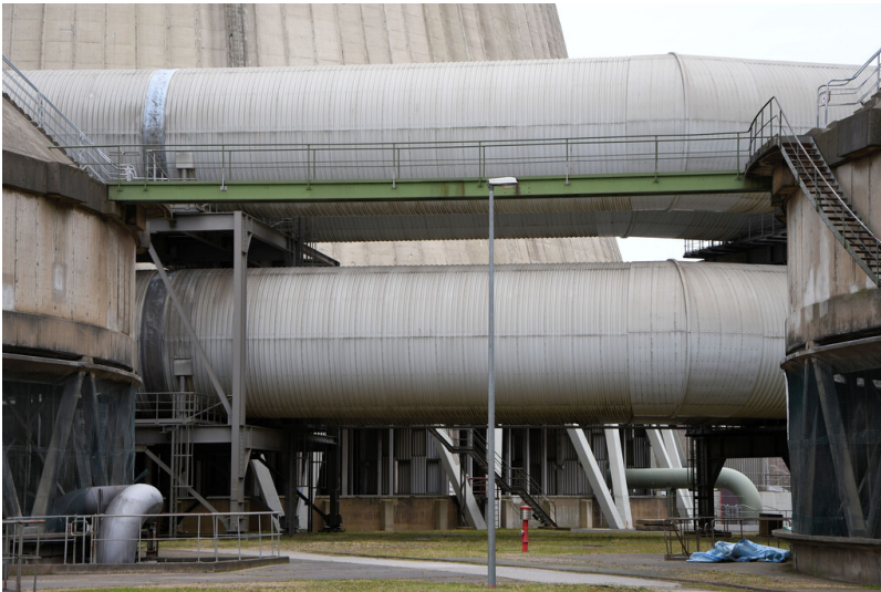
Kraftwerk Frimmersdorf II: Rauchgasreinigung, Rohgasrohre Blöcke P und Q, Ansicht von Süden; Foto: 22.03.2023 Fotograf/Urheber: Dr. Norbert Gilson
