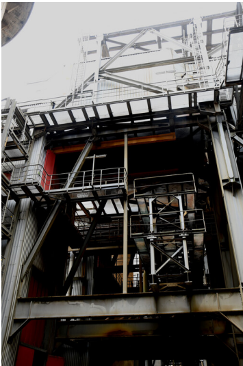
Kraftwerk Frimmersdorf II: Rohgaskanal Block O, Ansicht von Norden; Foto: 23.06.2023 Fotograf/Urheber: Dr. Norbert Gilson
