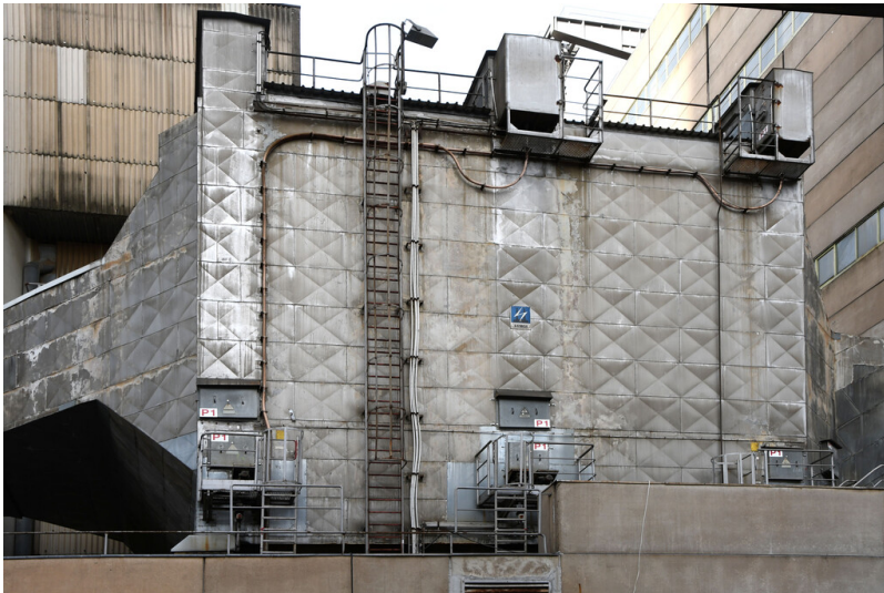
Kraftwerk Frimmersdorf II: Elektrofilter P1 von Block P, Ansicht von Westen; Foto: 21.03.2023 Fotograf/Urheber: Dr. Norbert Gilson
