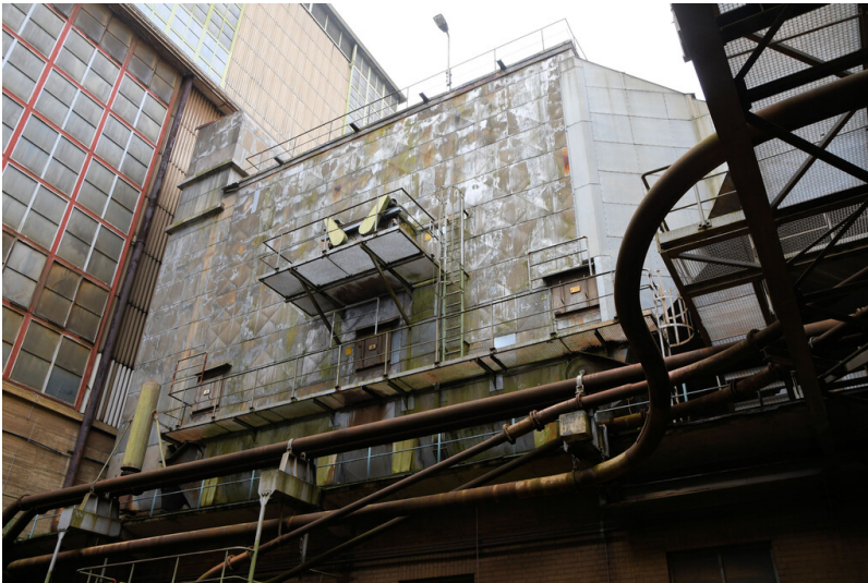
Kraftwerk Frimmersdorf II: Elektrofilter Block N, Ansicht von Norden; Foto: 23.06.2023 Fotograf/Urheber: Dr. Norbert Gilson
