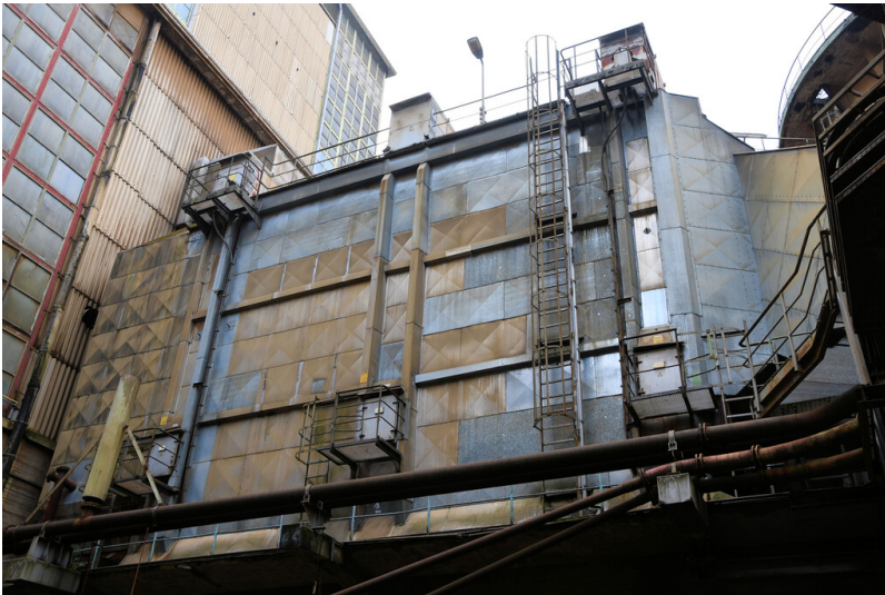
Kraftwerk Frimmersdorf II: Elektrofilter Block L, Ansicht von Norden; Foto: 23.06.2023 Fotograf/Urheber: Dr. Norbert Gilson
