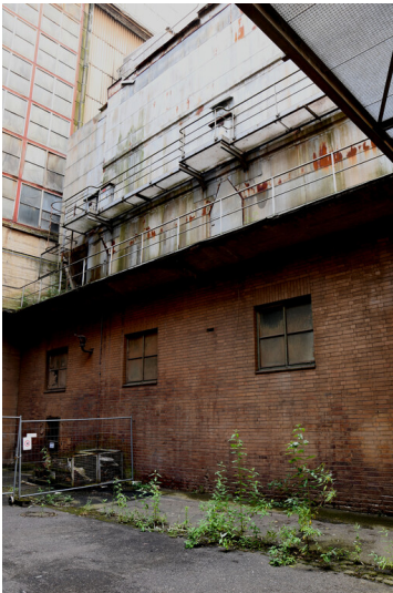
Kraftwerk Frimmersdorf II: Elektrofilter Block H, Ansicht von Norden; Foto: 23.06.2023 Fotograf/Urheber: Dr. Norbert Gilson
