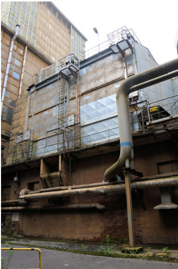
Kraftwerk Frimmersdorf II: Elektrofilter Block E, Ansicht von Norden; Foto: 23.06.2023 Fotograf/Urheber: Dr. Norbert Gilson
