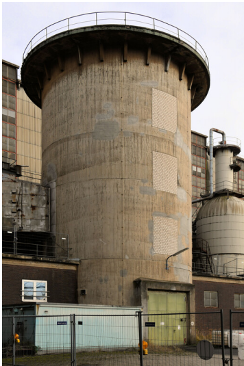
Kraftwerk Frimmersdorf II: Schornstein-Fundamentsockel Block B, Ansicht von Nordwesten; Foto: 21.03.2023 Fotograf/Urheber: Dr. Norbert Gilson
