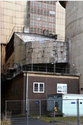
Kraftwerk Frimmersdorf II: Elektrofilter Block B, Rauchgaseinleitung in ehemaligen Schornstein B, Ansicht von Nordwesten; Foto: 21.03.2023 Fotograf/Urheber: Dr. Norbert Gilson
