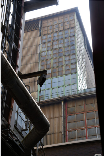
Kraftwerk Frimmersdorf II: Kesselhaus Block G, Ansicht von Westen; Foto: 23.06.2023 Fotograf/Urheber: Dr. Norbert Gilson
