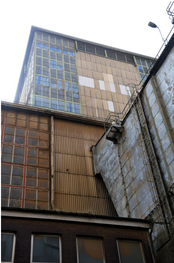
Kraftwerk Frimmersdorf II: Kesselhaus Block D, Ansicht von Nordwesten; Foto: 23.06.2023 Fotograf/Urheber: Dr. Norbert Gilson
