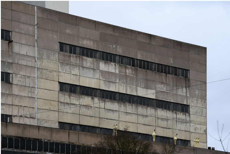
Kraftwerk Frimmersdorf II: Speisepumpen-Schwerbau Block Q, Ansicht von Süden; Foto: 22.03.2023 Fotograf/Urheber: Dr. Norbert Gilson
