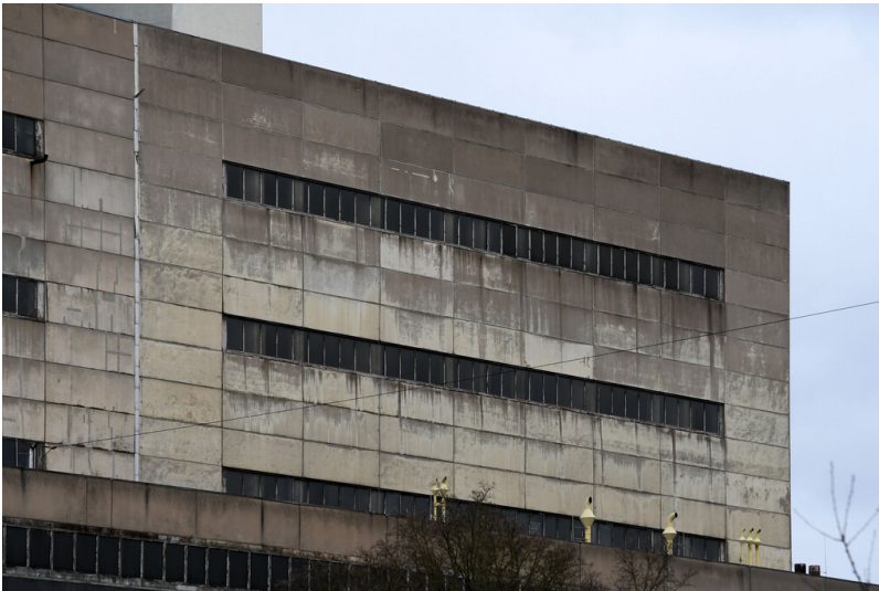
Kraftwerk Frimmersdorf II: Speisepumpen-Schwerbau Block Q, Ansicht von Süden; Foto: 22.03.2023 Fotograf/Urheber: Dr. Norbert Gilson
