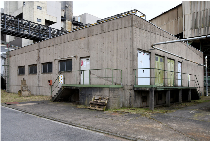
Kraftwerk Frimmersdorf II: Eisenausscheidung 3, Ansicht von Nordwesten; Foto: 22.03.2023 Fotograf/Urheber: Dr. Norbert Gilson
