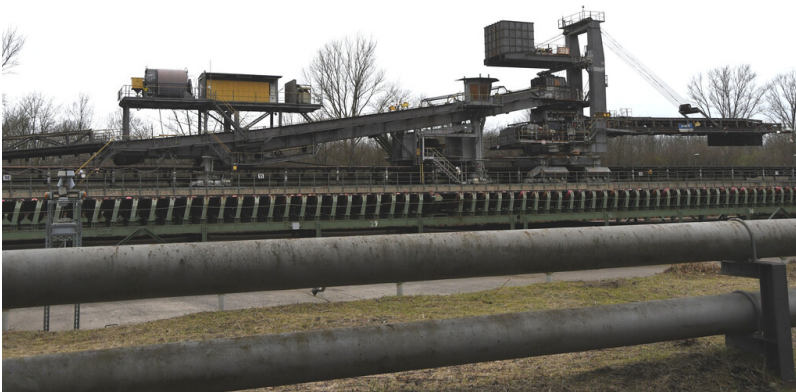
Kraftwerk Frimmersdorf II: Bandschleifenwagen 988 am Grabenkunker 2, Ansicht von Osten; Foto: 22.03.2023 Fotograf/Urheber: Dr. Norbert Gilson
