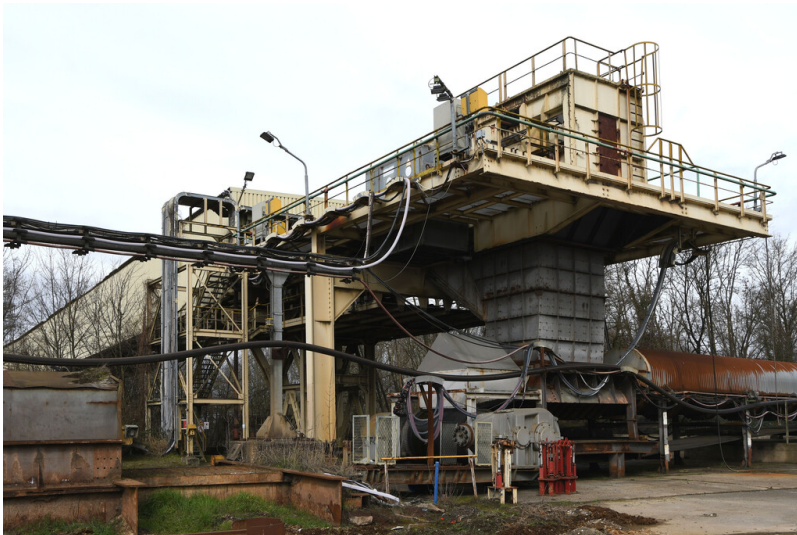
Kraftwerk Frimmersdorf II: Bekohlungsanlage, Übergabestation von der Bandanlage GF vom Kohlebunker Garzweiler auf das Bunkerbeschickungsband von Grabenbunker 2, Ansicht von Süden; Foto: 22.03.2023 Fotograf/Urheber: Dr. Norbert Gilson
