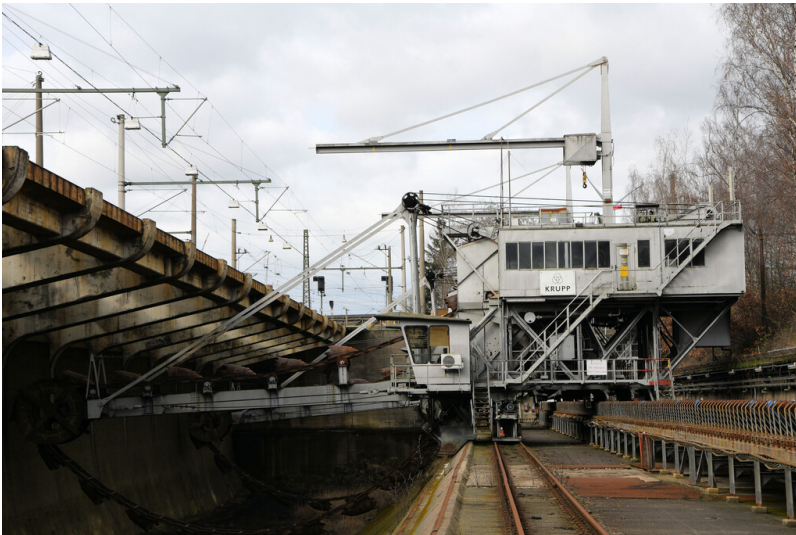
Kraftwerk Frimmersdorf II: Bunkerbagger 3 im Grabenbunker 1, Ansicht von Osten; Foto: 22.03.2023 Fotograf/Urheber: Dr. Norbert Gilson
