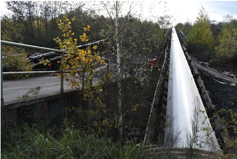
Tagebau Inden: zu Bandschleifenwagen 982 im Kohlebunker Inden führendes Förderband, Ansicht von Nordosten; Foto: 09.11.2022 Fotograf/Urheber: Dr. Norbert Gilson
