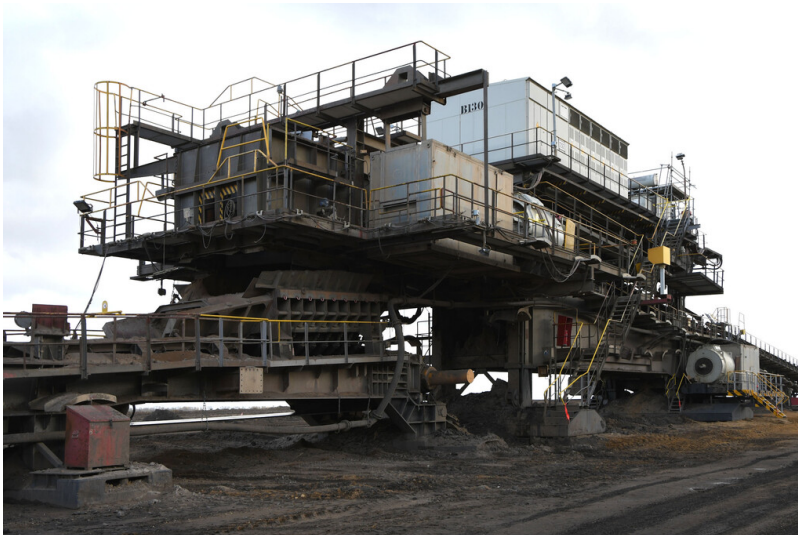
Tagebau Inden: 1.500-kW-Bandantriebsstation auf der 1. Gewinnungssohle (von Schaufelradbagger 255 zum Bandsammelpunkt); Foto: 09.11.2022 Fotograf/Urheber: Dr. Norbert Gilson
