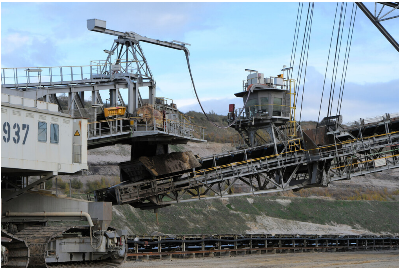
Tagebau Inden: Übergabevorrichtung von Bandschleifenwagen 937 auf Zubringerband des freihängenden Zubringerauslegers von Absetzer 753; Foto: 09.11.2022 Fotograf/Urheber: Dr. Norbert Gilson
