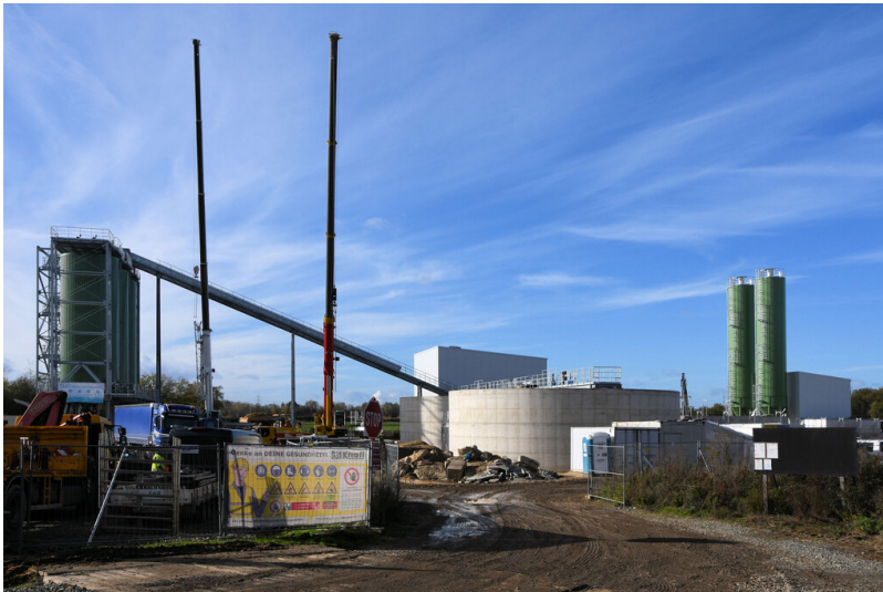
Tagebau Hambach: Baustelle der Grubenwasserreinigungsanlage Oberzier, Ansicht von Süden; Foto: 07.11.2022 Fotograf/Urheber: Dr. Norbert Gilson
