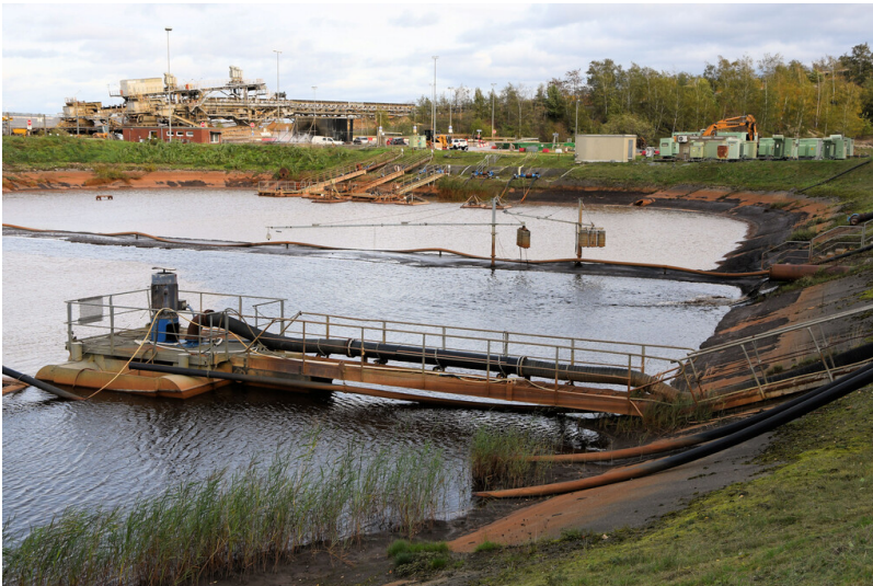
Tagebau Hambach: Hauptwasserhaltung +12 (Becken 1), Detailsicht von Südwesten; Foto: 07.11.2022 Fotograf/Urheber: Dr. Norbert Gilson
