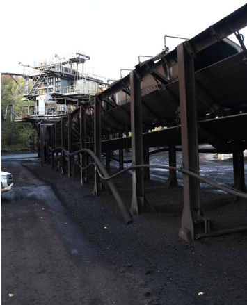
Tagebau Hambach: Förderband zu Bandschleifenwagen 989 (Bunker 1) mit Bandantriebs- und Übergabestation, Ansicht von Südosten; Foto: 07.11.2022 Fotograf/Urheber: Dr. Norbert Gilson
