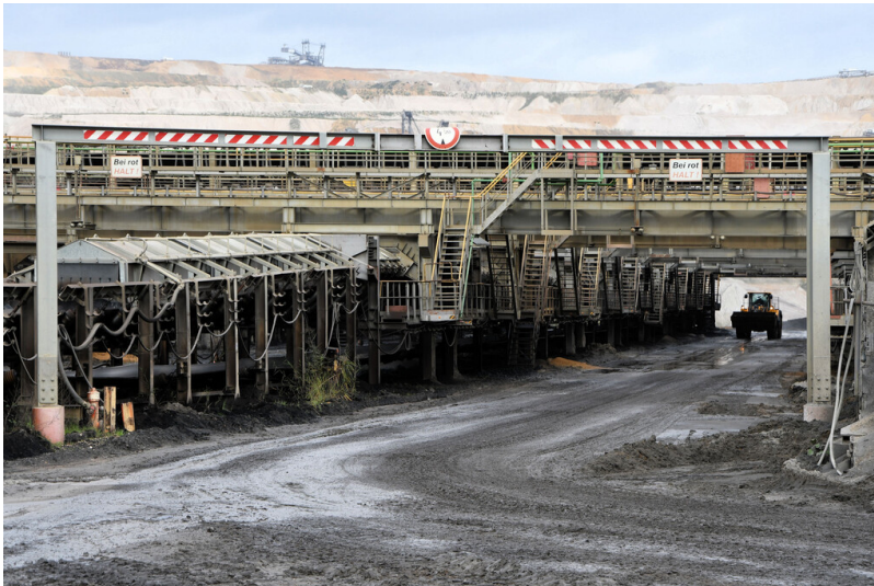
Tagebau Hambach: Fahrstraße unter den Verschiebeköpfen des Bandsammelpunkts, Ansicht von Süden; Foto: 07.11.2022 Fotograf/Urheber: Dr. Norbert Gilson
