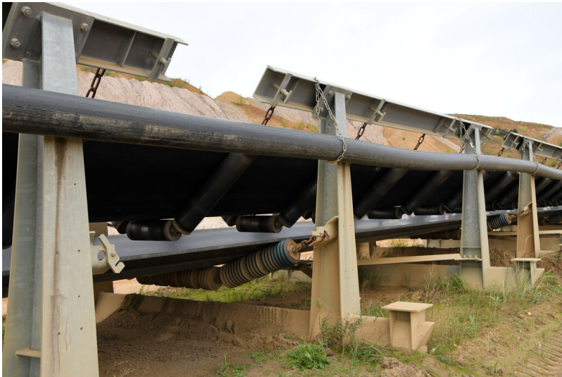
Tagebau Hambach: Bandanlage B 2800 auf Kippenstrosse 7; Foto: 07.11.2022 Fotograf/Urheber: Dr. Norbert Gilson
