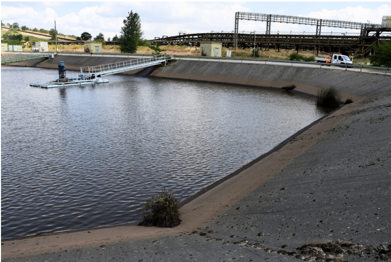
Tagebau Garzweiler: Hauptwasserhaltung WH 3, südöstliche Pumpstationen, Ansicht von Süden; Foto: 26.06.2023 Fotograf/Urheber: Dr. Norbert Gilson
