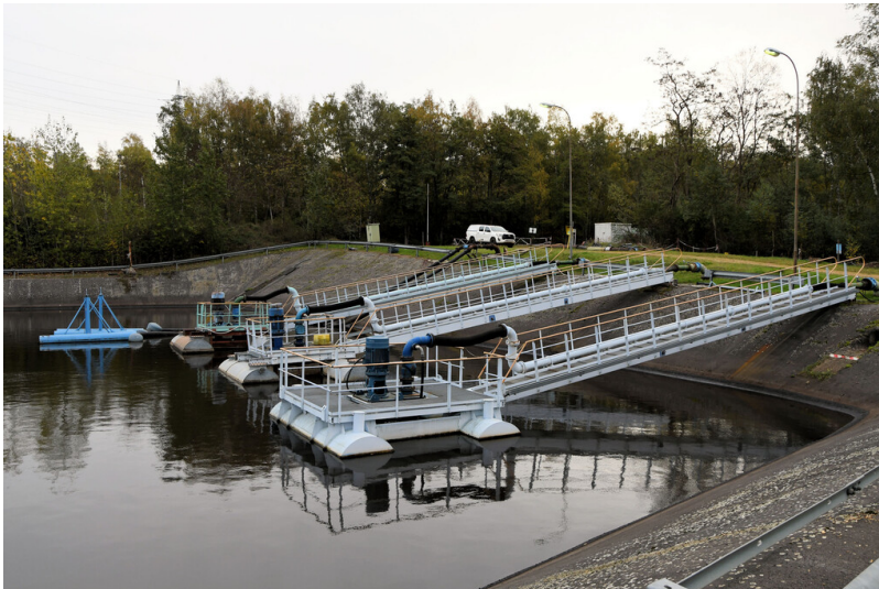
Tagebau Garzweiler: Abpumpstationen der Hauptwasserhaltung 1, Ansicht von Westen; Foto: 03.11.2022 Fotograf/Urheber: Dr. Norbert Gilson
