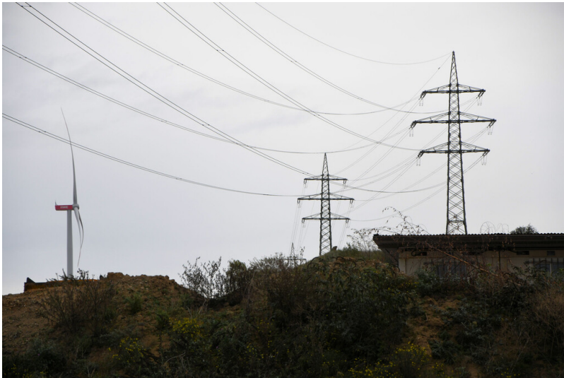
Tagebau Garzweiler: 110-kV-Anschlussfreileitung der Umspannanlage Garzweiler, Ansicht von Westen; Foto: 03.11.2022 Fotograf/Urheber: Dr. Norbert Gilson
