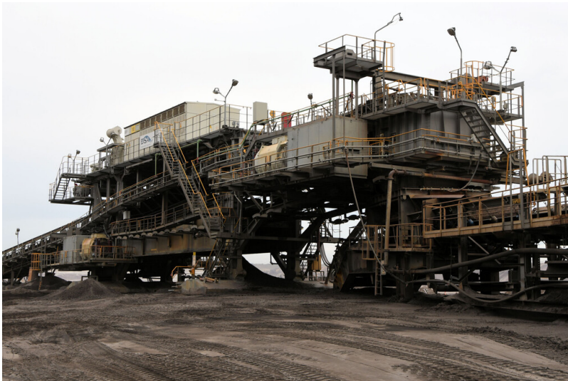
Tagebau Garzweiler: Bandantriebsstation 4 x 1.500 kW für Bandanlage B 2800; Foto: 03.11.2022 Fotograf/Urheber: Dr. Norbert Gilson
