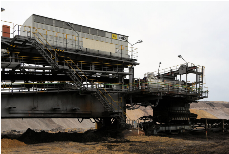
Tagebau Garzweiler: Bandantriebsstation 4 x 1.500 kW (Bandanlage 2200), Aufgabeschurre auf das abgehende Band; Foto: 03.11.2022 Fotograf/Urheber: Dr. Norbert Gilson
