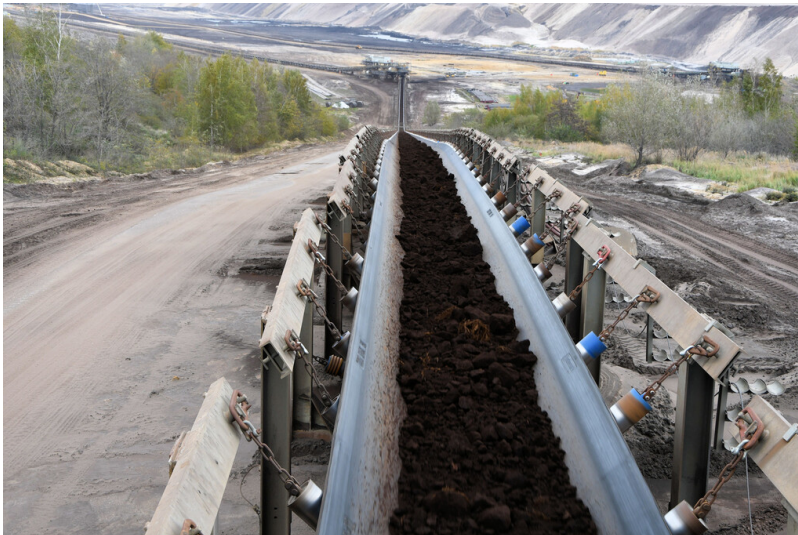
Tagebau Garzweiler: rückbare Bandanlage B 2800 auf der 5. Sohle; Foto: 03.11.2022 Fotograf/Urheber: Dr. Norbert Gilson
