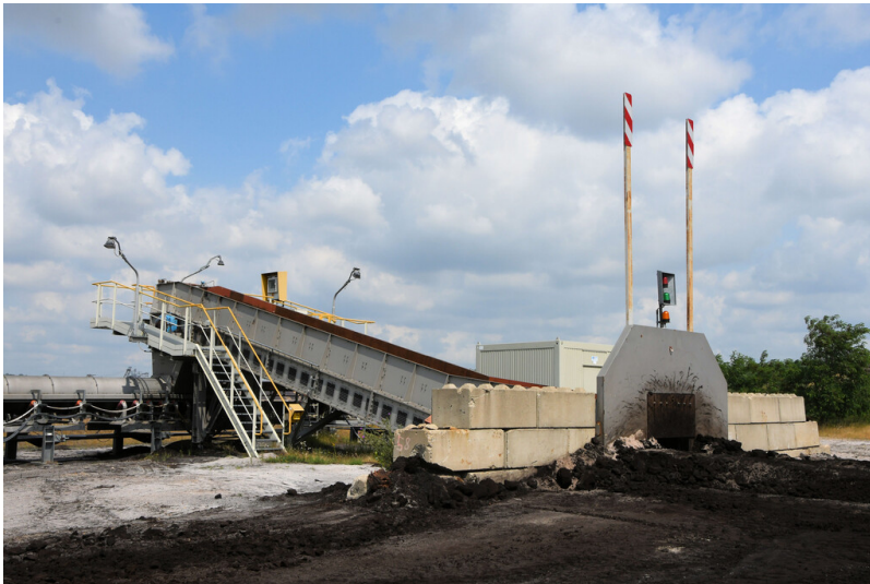
Tagebau Garzweiler: Kohlekonditionierungsanlage, Aufgabevorrichtung auf die Bandanlage Richtung Verschiebekopf, Ansicht von Südosten; Foto: 26.06.2023 Fotograf/Urheber: Dr. Norbert Gilson
