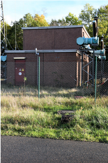
Tagebau Fortuna: 110-kV-Schaltheis der Umspannanlage, Ansicht von Westen; Foto: 09.11.2022 Fotograf/Urheber: Dr. Norbert Gilson
