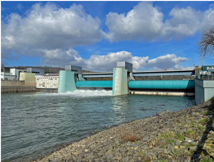
Stauwehr Baldeneysee Fotograf/Urheber: Karl Peter Wiemer
