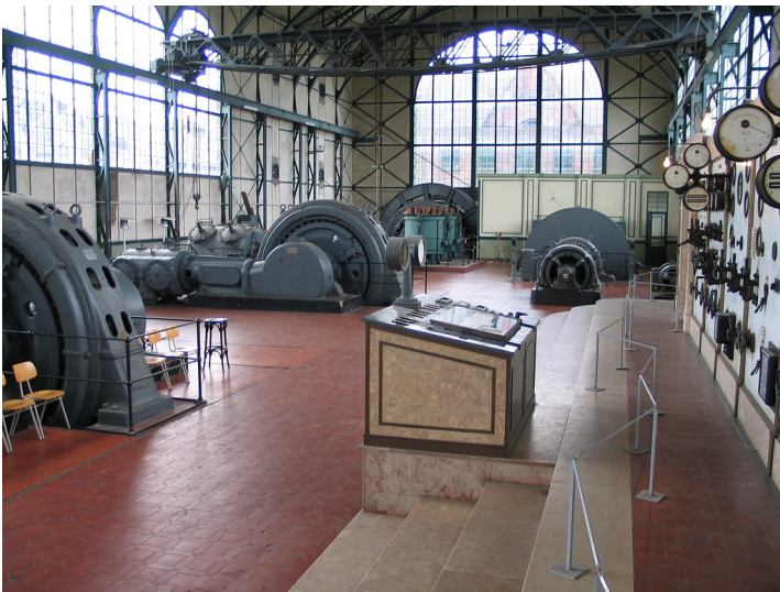
Kulturlandschaftsbereich Dortmund Zeche Zollern und Halde: Blick in die Maschinenhalle (2005). Fotograf/Urheber: Helfmann
